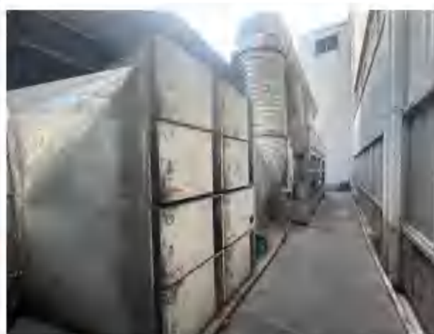
FQ-010815废气排放口（远照）
