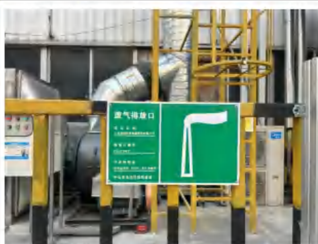
FQ-010817废气排放口（远照）
