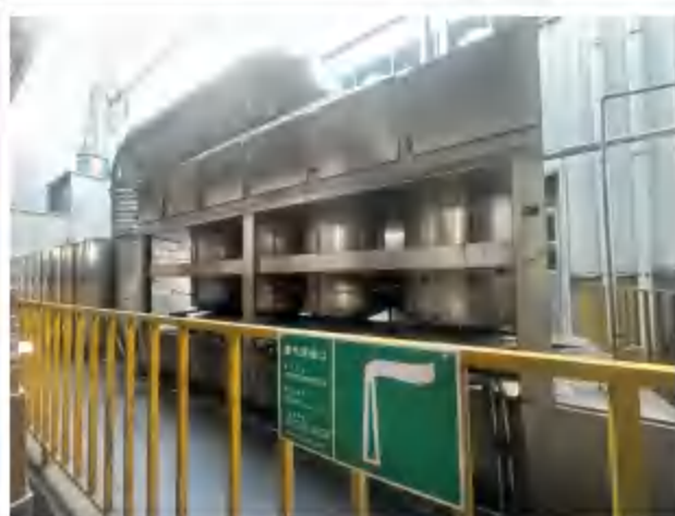
FQ-010816废气排放口（远照）
